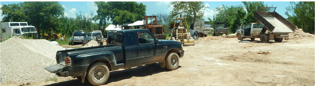
FIGURA 9. RELLENO DEL CAUDAL CON ESCOMBRO DE MATERIAL DE CONSTRUCCIÓN.
