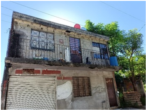
FOTOGRAFÍA 4. MUROS SIN APLANADOS.
