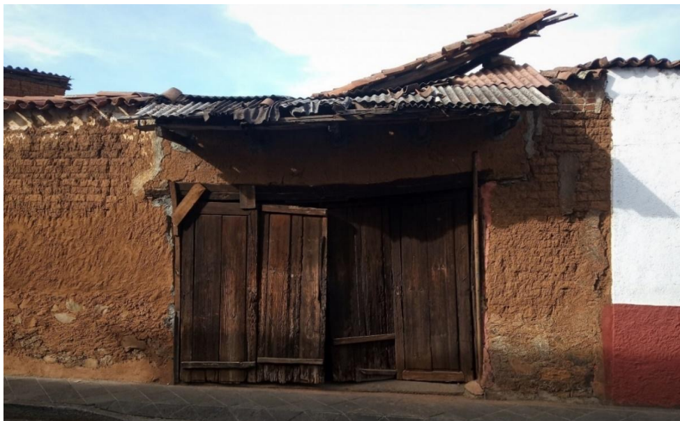
FIGURA 1. VIVIENDA DE ADOBE EN ESTADO DE DETERIORO EN SAN NICOLÁS OBISPO, MICHOACÁN.
