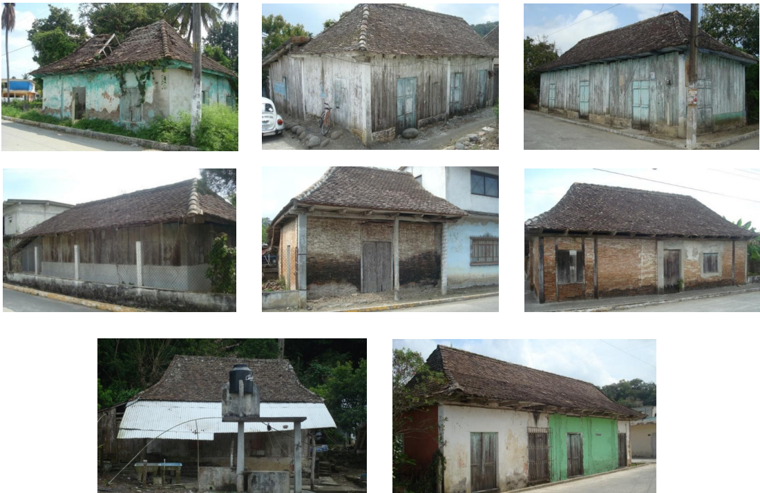
FIGURA 14-21. VIVIENDAS VERNÁCULAS EN MUY MALAS CONDICIONES EN JICALTEPEC. FUENTE: MORALES, C.C., 2013.
