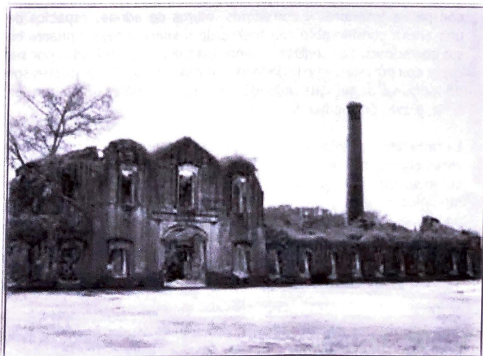
Foto 4. Vista del estado actual del “Ticuí”. Imagen: José Luis López Suárez. Foto 5. Daños del Chacuaco del Ticuí. Imagen propia.
