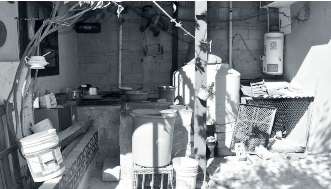
FIGURA 8. TANQUES DE ALMACENAMIENTO DE AGUA CONTAMINADOS. FUENTE: DÍAZ (2019).
