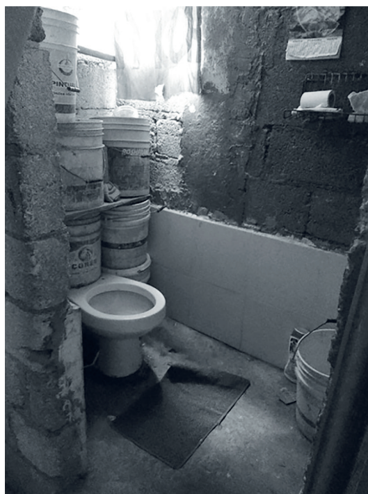
FIGURA 6. CUARTO DE BAÑO SIN PUERTA Y SIN ALIMENTACIÓN DE AGUA POTABLE.
