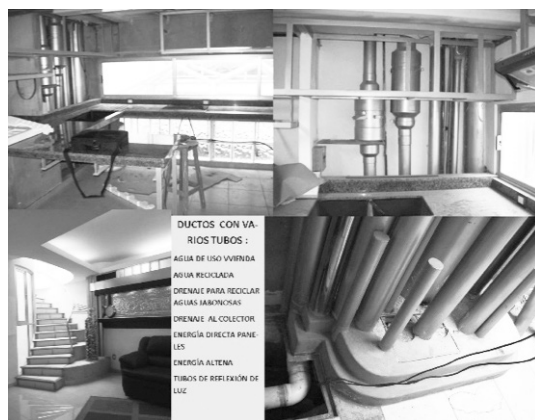
FIGURA 6. DUCTOS Y TRINCHERA DE CONDUCCIÓN DEL AGUA.
